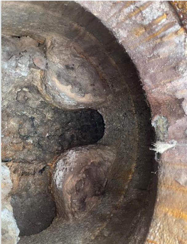
oppumpningsbrønd med stor kage
