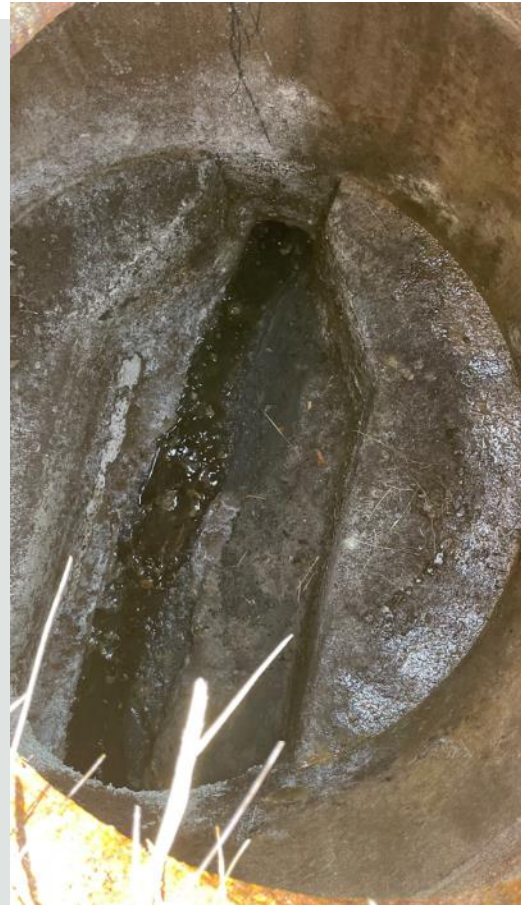
Slutbrønd, tegn på tærring
