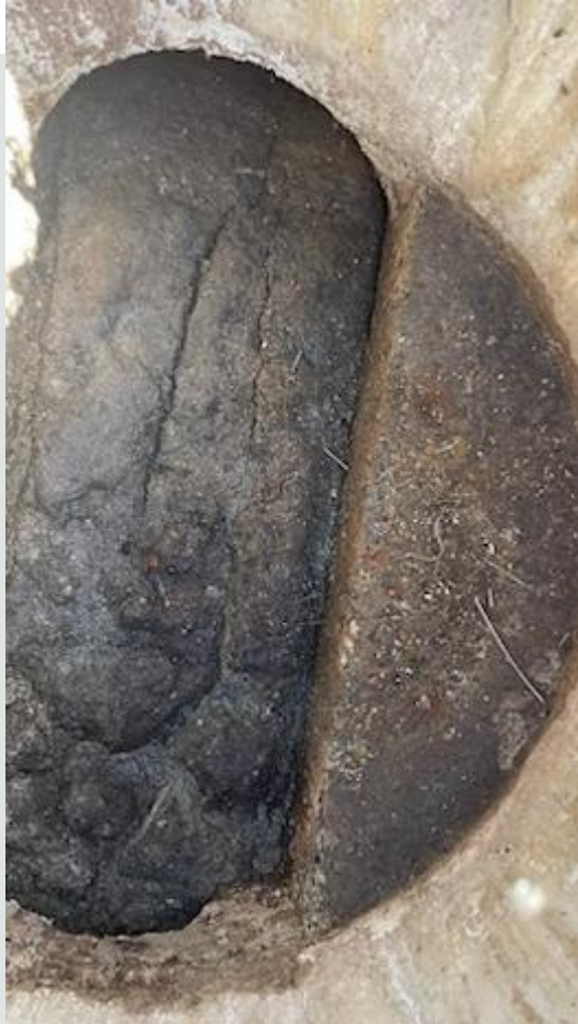
oppumpningsbrønd med stor kage
