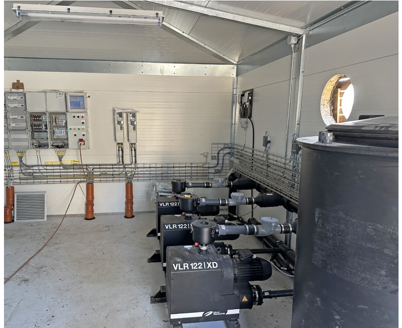
Vakuumstation overbygning: Overbygning i vakuumstation, med vakuumpumperne, som suger luften ud af vakuumtanken og sikrer dermed, at vakuum opretholdes på ca. 0,6-0,7 bar. Forrest i billedet ses et kulfilter, som renser afkastet.
