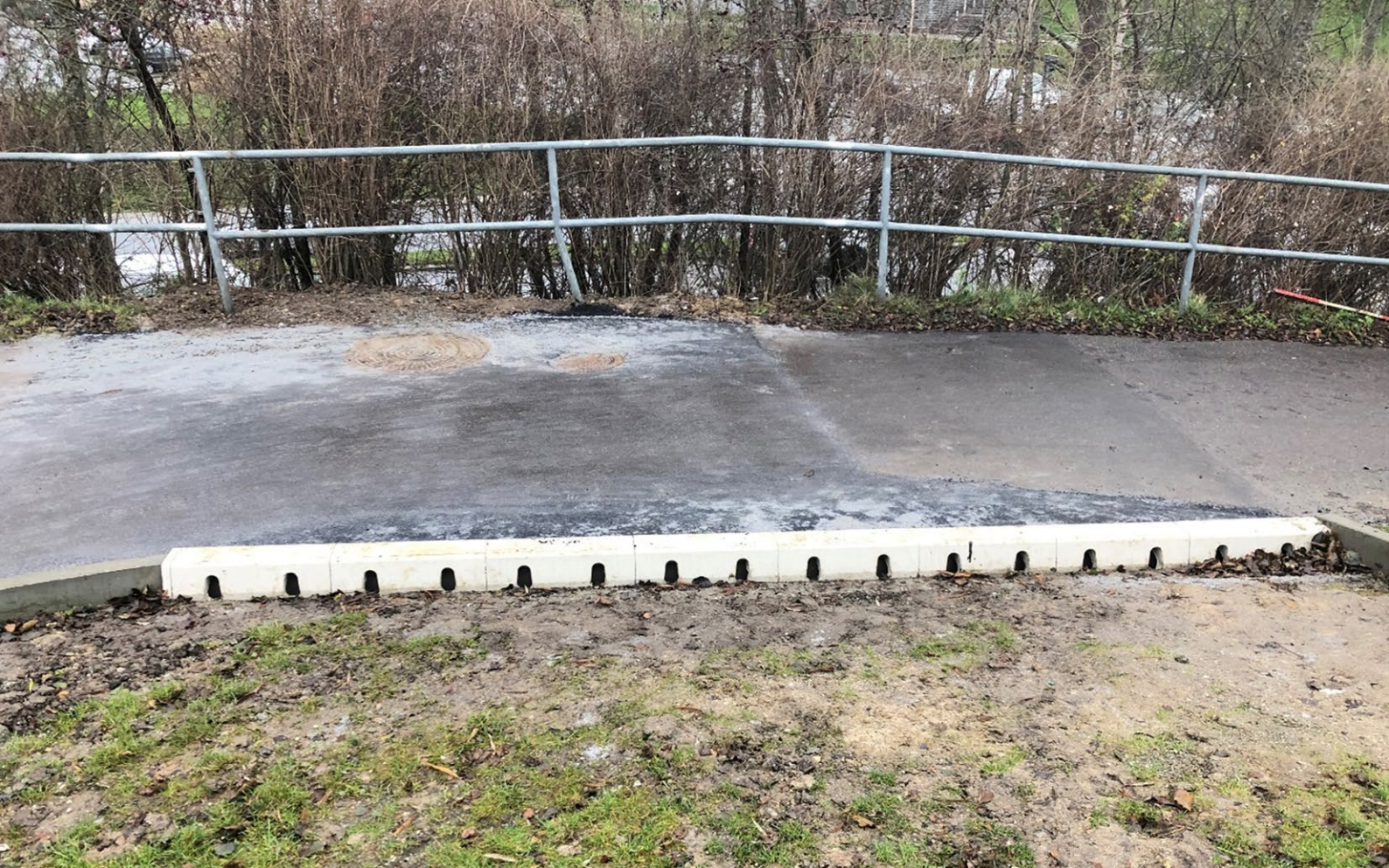
Figur 3 Linjedræn til opsamling af afstrømmende regnvand ved nyt forsøgsanlæg i Viby-bydelen i Aarhus.
