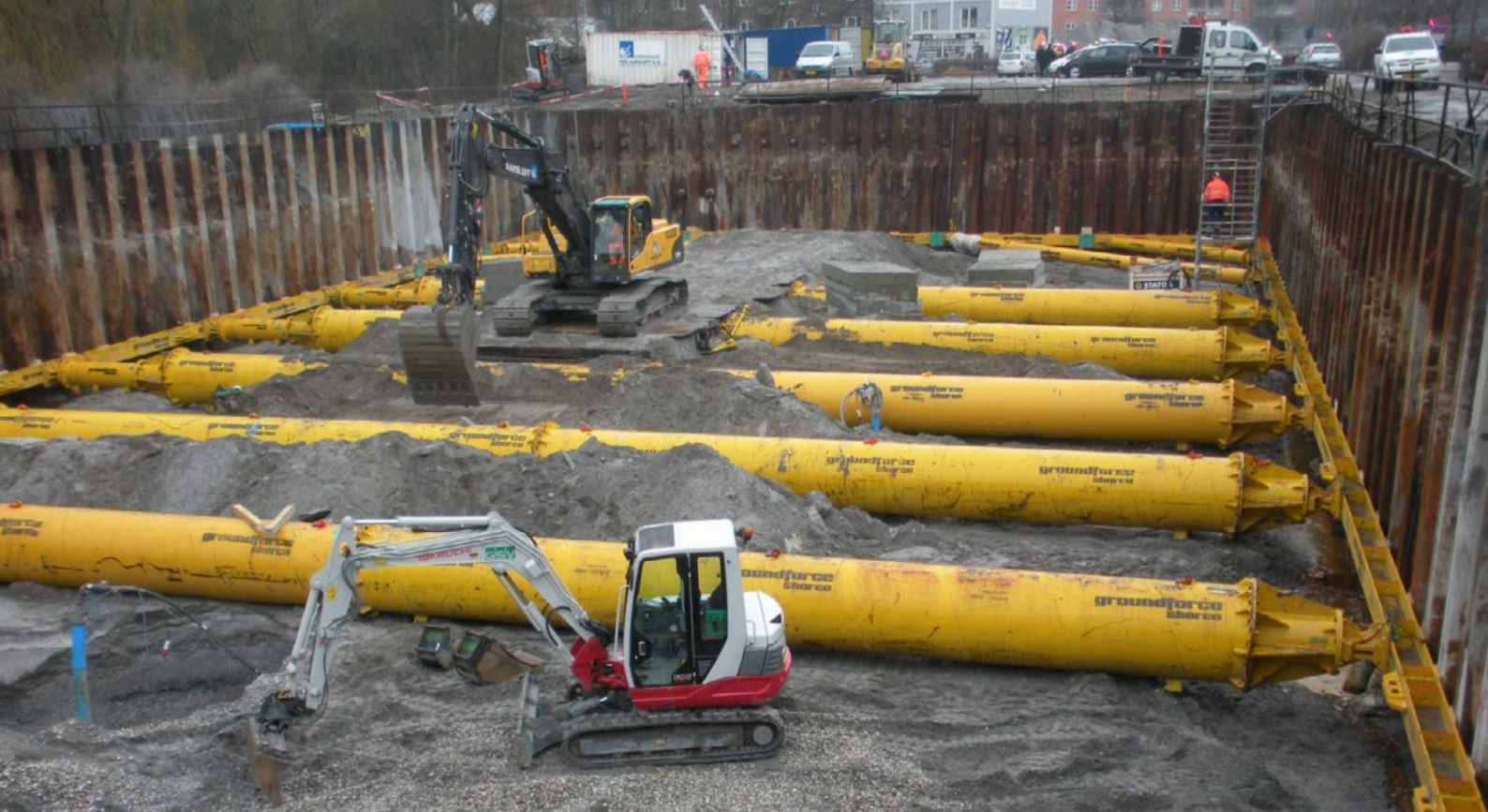
Figur 4. 17 tons hydraulisk stræk monteret i bassinet på Carl Blochs Gade. Udgravningen skulle foretages imellem strækket indtil en dybde på indtil ca. 4 meter under strækket.
