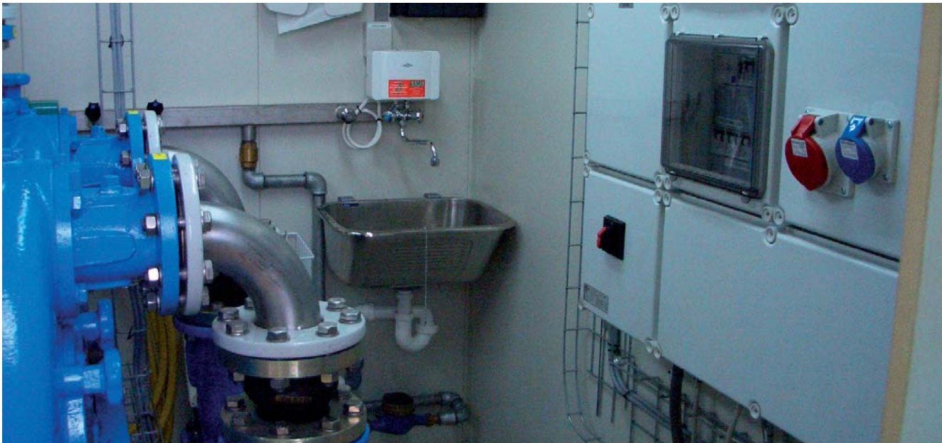
Manglende afstand foran el-tavlen. Der skal være minimum 70 cm!
