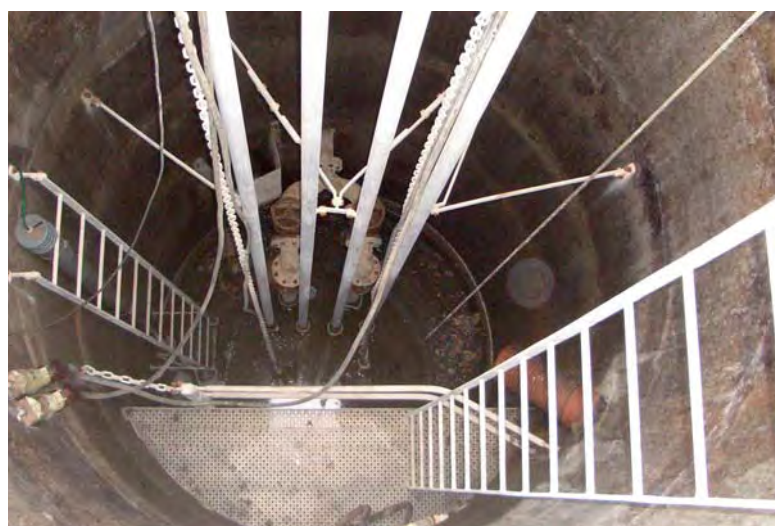
Mere end 8 meter dyb station med en umulig indretning med ventiler bag guiderør i pumpeump
