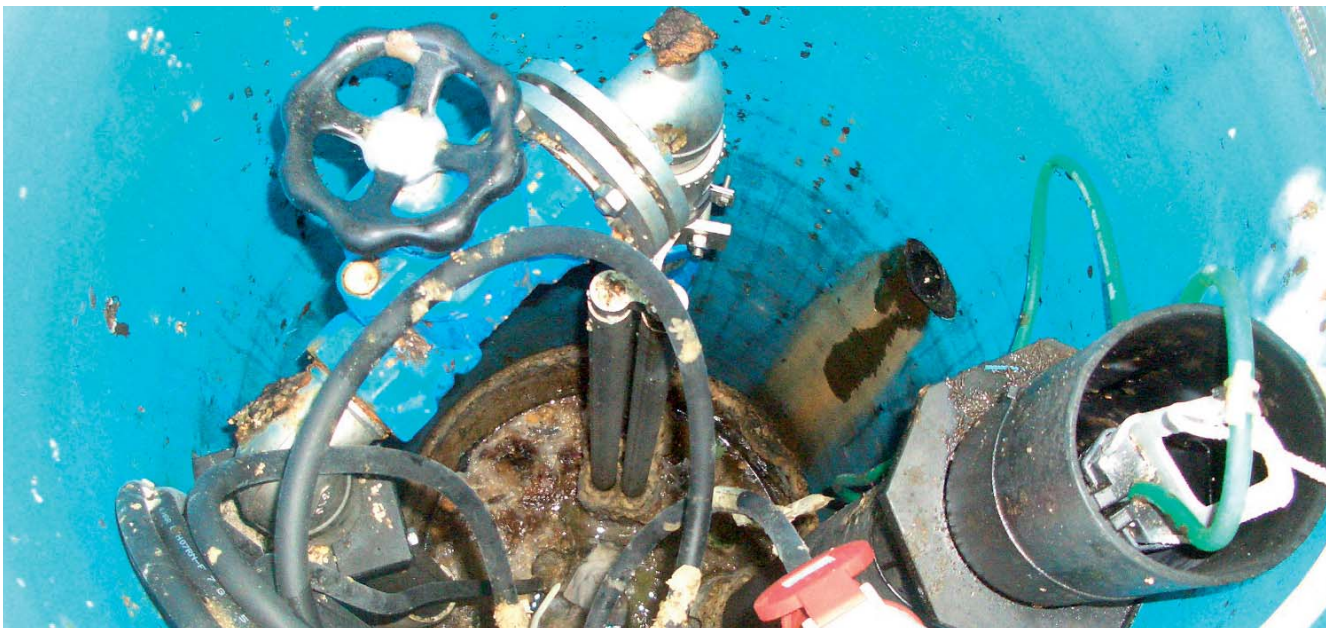
Minipumpestation med tykt slamlag som grobund til svovlbrinte
