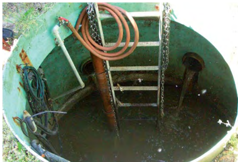
Meget tæret stige, ulovlig vandinstallation mm.
