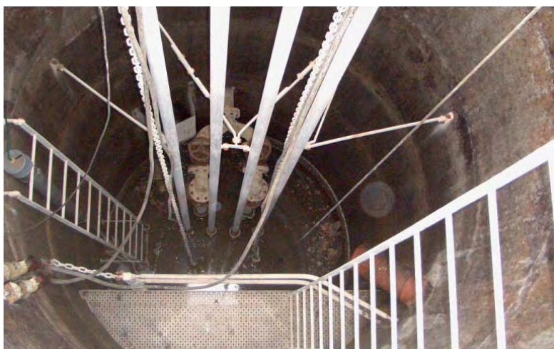
Mere end 8 meter dyb station med en umulig indretning med ventiler bag guiderør i pumpe-sump
