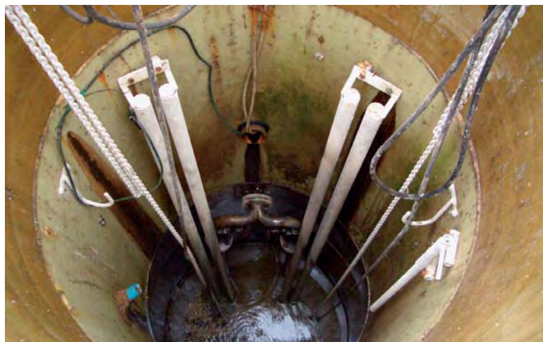
Pumpestation med ventiler anbragt bunden, men skakten er så snæver at adgang er ulovligt!
