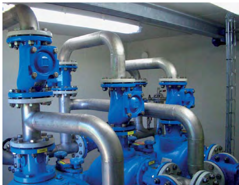
Kranbjælken uanvendelig med mindre rørinstallationen fjernes helt, og så er pumpestationen ude af drift.
