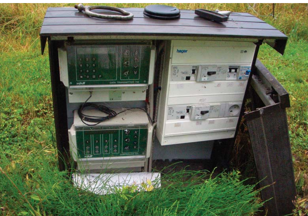
Elendigt arbejdsmiljø for en elektriker ved denne type eltavle med pumpestyring etableret så man skal ligge på jorden ved reparationsarbejder.
