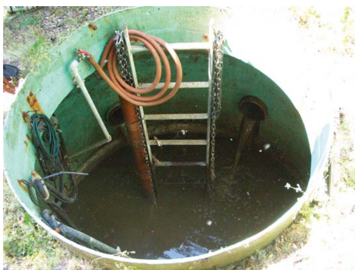
Særdeles usikker stige til adgang til en pumpebrønd.
