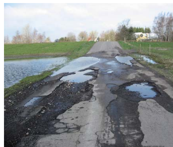
Veje bliver nedbrudt på grund af dårlig eller manglende dræning.
